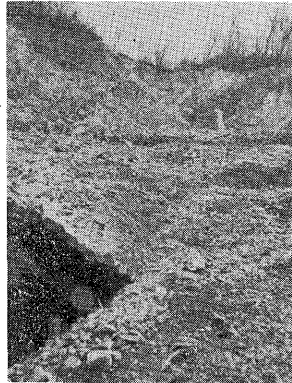
図版 11 下より崩壊面を仰ぐ
