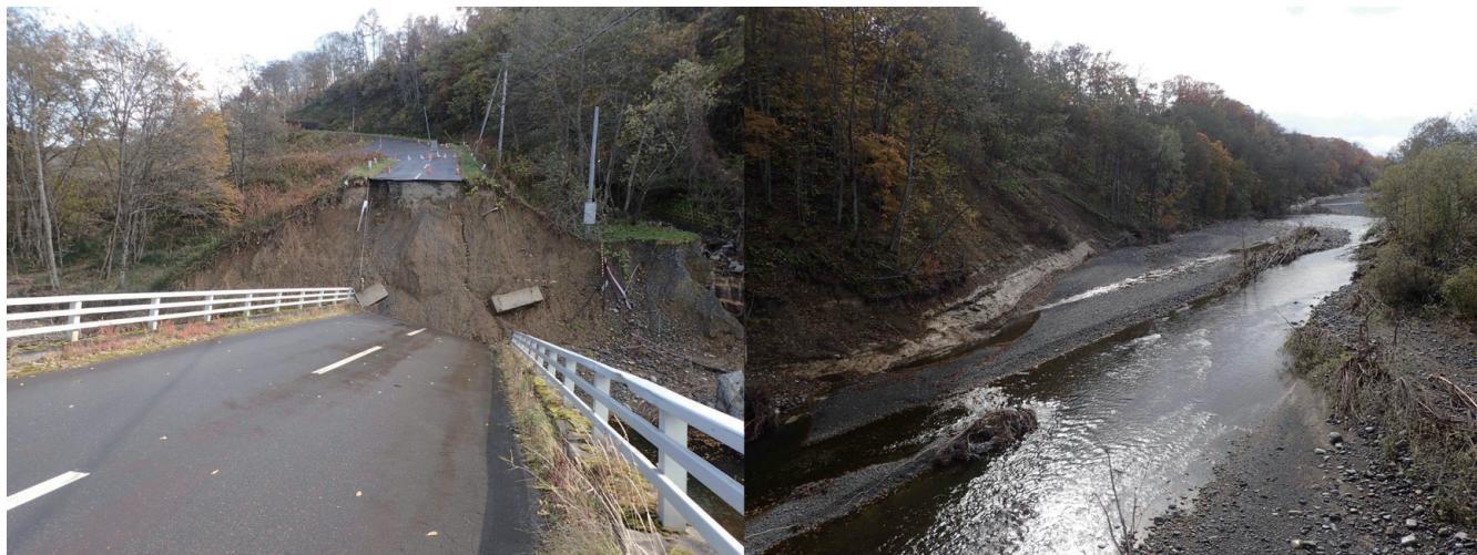
第 1 図 岩内川流域の明星橋橋梁の被災状況。橋梁の上流側（右の写真）では、洪水流による側方侵食により新たな鮮新世最末期～前期更新世の長流枝内層の露頭が河床に出現し、その上方では小規模な斜面崩壊によって中期更新世の光地園礫層が露出した。
