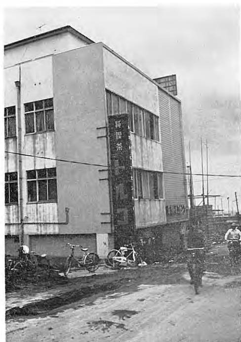
図版 27 駅前ビルディングの沈下傾倒
