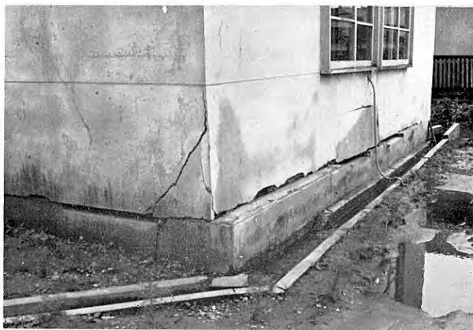
図版 85 新潟県北蒲原郡中条町 (2) 大田小学校校舎に生じた亀裂 建物は建築後3年ほどしかたっていないが、基礎から最大30 cmも 移動している。(鈴木泰輔撮影)
