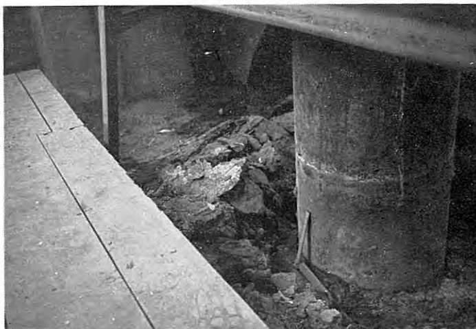
図版 49 通産省地盤沈下大形観測井の抜け上がり（約 30 cm）
