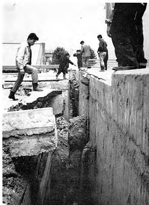
図版 23 昭和大橋北端のとりつけ部の分離 両者は 60 cm 開き、盛土の部分が 50 cm 前後下がっている。(図版 19 参照)
