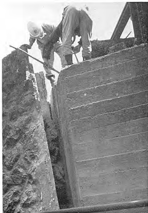
図版 59 羽越線勝木駅北方 約 400 m の小鉄橋橋脚 破損 (鈴木泰輔撮影)
