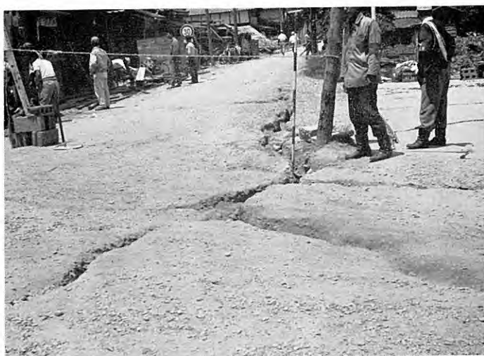
図版 76 村上市八日市の道路面に生じた地割れ （村上市災害対策本部提供）
