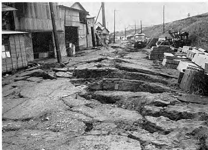
図版 17 越後線に平行な道路の地割れ 道路に直角な方向（信濃川の方）の地割れと道路方向の地割れとが発達する。 （図版 16 の左手の道路に連続する）
